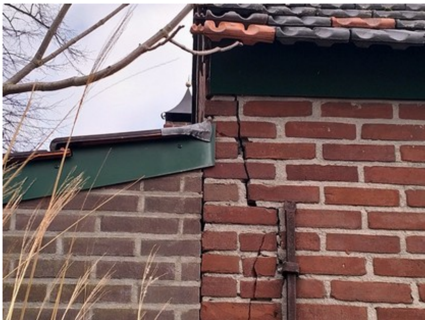
Zuidkant van bakstenen schuur, met scheur. Grenzend aan plangebied. Foto: V. Stuit| Ecoresult B.V.
