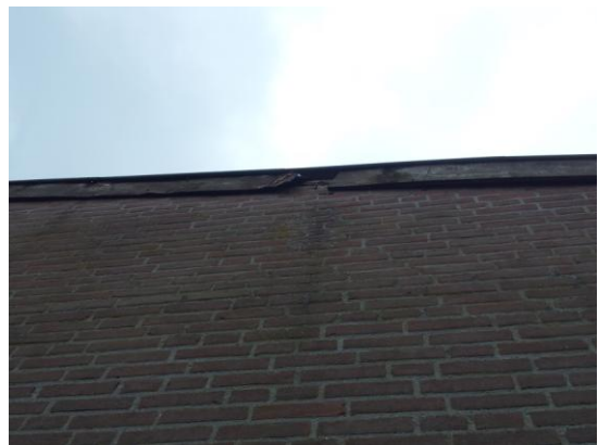
Foto 6: ruimte achter boeiborden bereikbaar
