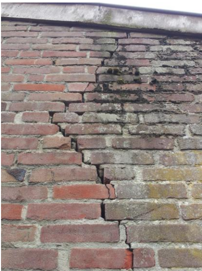
Foto 5: scheuren waardoor de spouw bereikt kan worden
