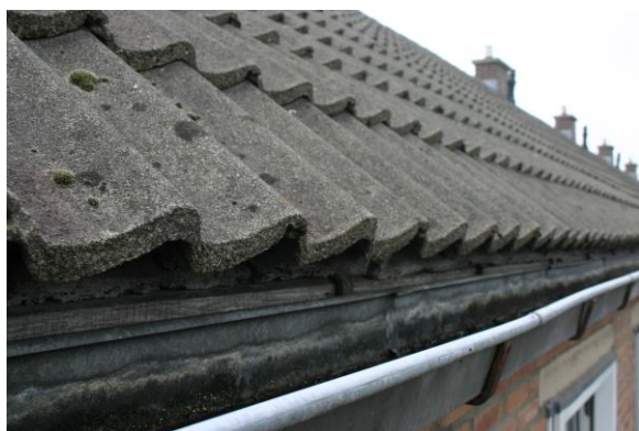
Figuur 4.2.1. De meeste daken zijn niet voorzien van vogelschroot.
