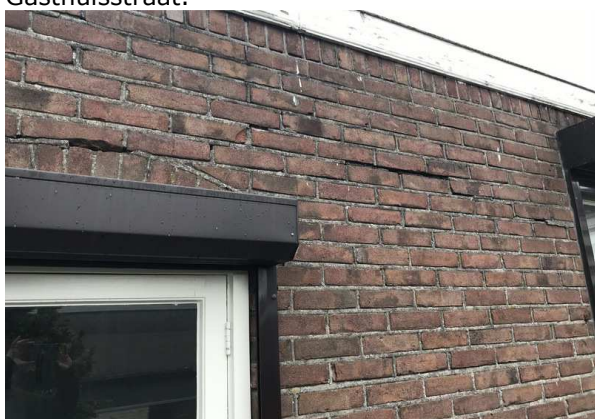
Figuur 12. Spleten en gaten in de buitenmuur van de woning.
