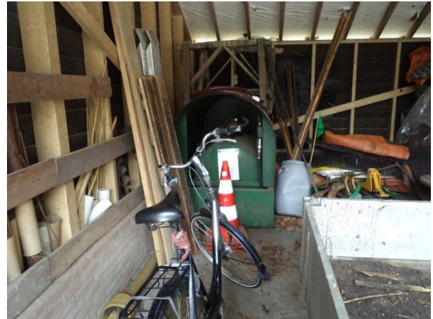
Bovengrondse dieseltank in lekbak in zuidoosthoek werkschuur
