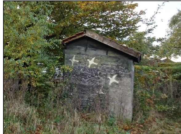
Figuur 11. De schuren zijn in vervallen staat. Op deze schuur zijn nog maar enkele losliggende pannen aanwezig, waardoor de ruimtes daaronder onder invloed staan van neerslag (lekkage).
