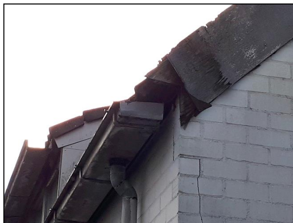
Figuur 11. Ruimten tussen het dak en dakbeschoot achter op het terrein van de Hoofdstraat 16.
