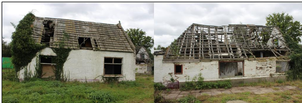
Figuur 4 Het dak van de bebouwing aan de Erasstraat 105 is alreeds deels ingestort.
