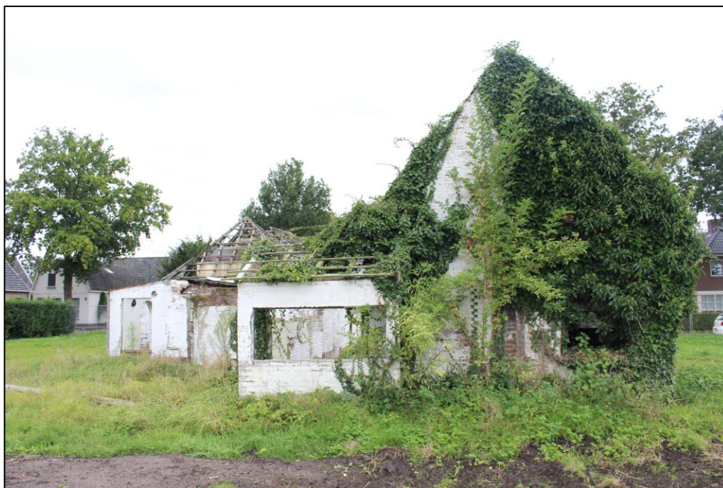
Figuur 1 De bebouwing welke is gelegen aan de Erasstraat 105 te Kaatsheuvel is in erbarmelijke staat.
