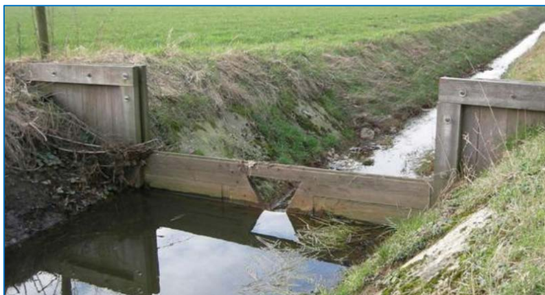
Figuur 14. Voorbeeld knijpstuw (LOP stuw) met V-vormige schotbalken. Bron: Waterschap Brabantse Delta
