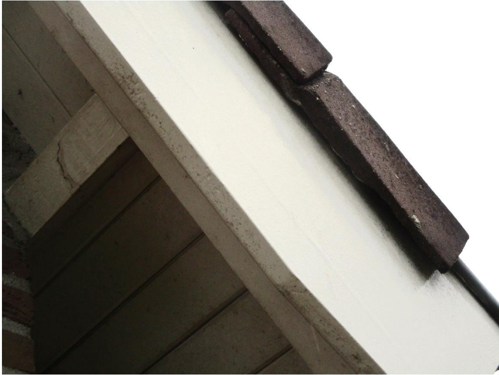
Figuur 3 De kantpannen kieren licht, maar het boeiboord eronder is zodanig glad afgewerkt dat vleermuizen hier geen verblijfplaats kunnen bereiken.
