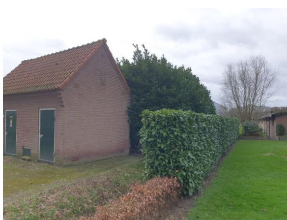
Transformatorhuisje op aangrenzende perceel. Beuken en laurier hagen op perceelsgrens.
