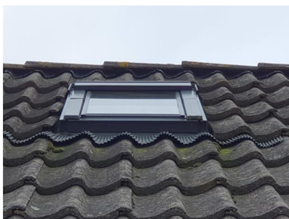
Vogelschroot rondom dakramen en onder nokpannen
