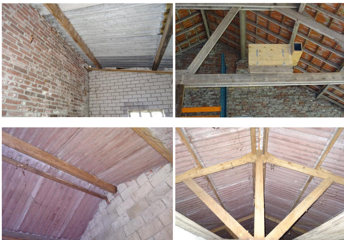
Afbeelding 11 t/m 14. Afwezigheid van dakbeschot in de te slopen opstallen. Bron: R.J.L. Bijvelds 17-05-2021
