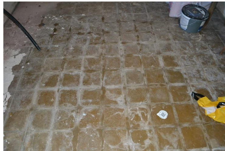
Plavuizen in kelder.
