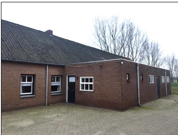
Aanbouw met ventilatieopeningen afgewerkt met cement, geen toegang tot spouw
