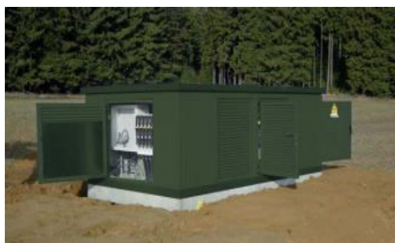
Afbeelding 11: Voorbeeld hekwerk en trafostation
