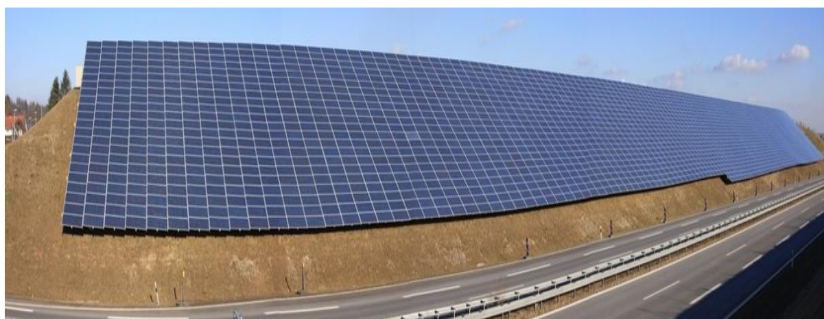
Afbeelding 19: Zonne installatie langs de A94 dicht bij Tosing
