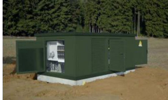
Afbeelding 10: Voorbeeld hekwerk en trafostation
