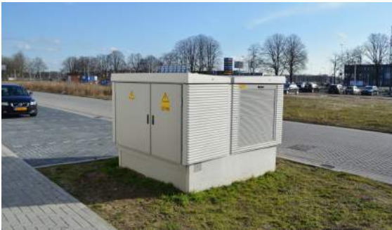
foto transformator voorziening materiaal: beton kleur: lichtgrijs
