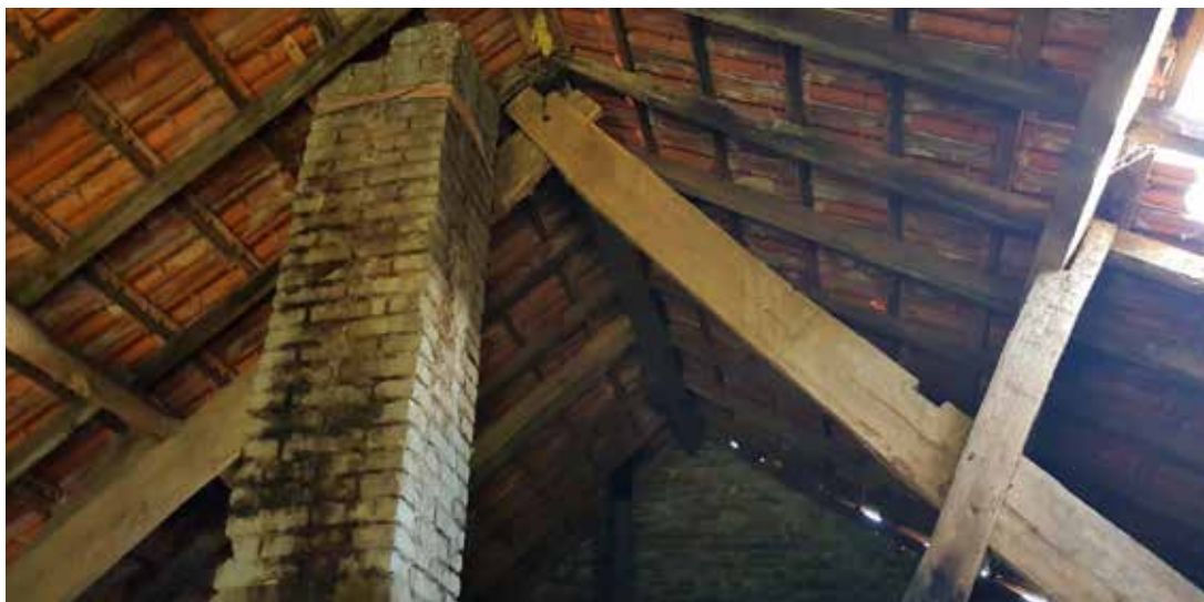
Het pannendak in het voorhuis, geen dakbeschot aanwezig.
