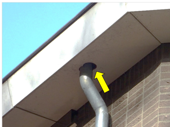
Figuur 5.1 Opening langs de regenpijp.
