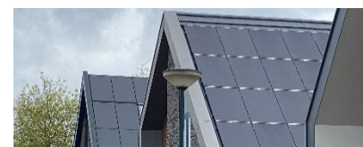
Daken van antraciet, zonnepanelen geïntegreerd in het dakvlak
