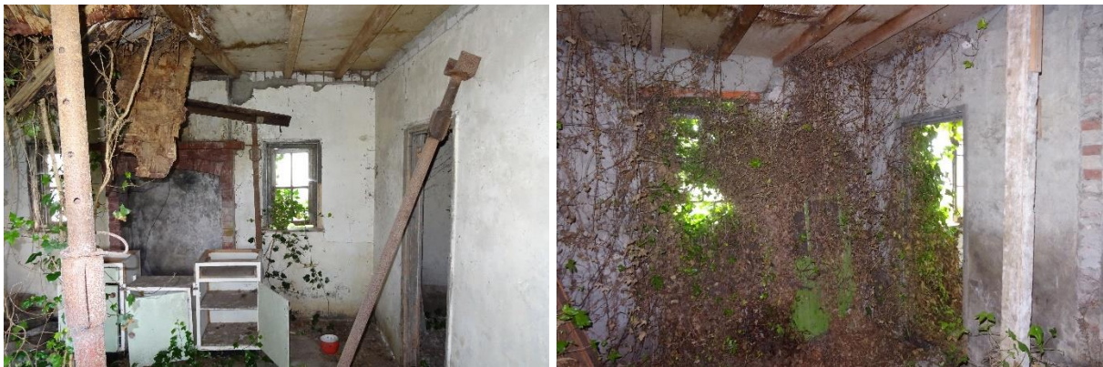
Afbeelding 9 en 10: Woning met lekkages en klimop welke de woning overneemt. Bron: R.J.L. Bijvelds. Datum: 26-07-2021
