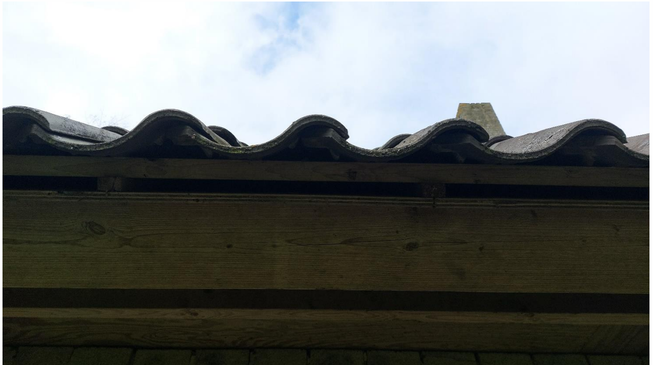
Figuur 4.4.1. Vogelschroot is afwezig waardoor vleermuizen onder de pannen kunnen kruipen.
