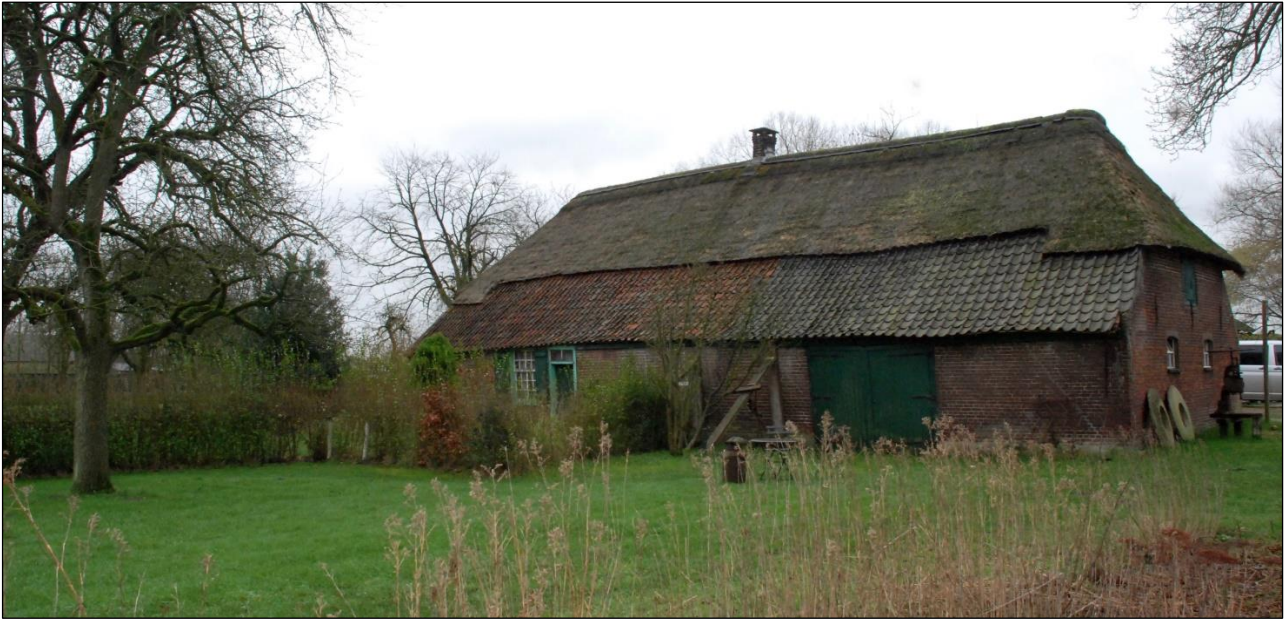
Figuur 9: huidige staat langgevelboerderij, muren moeten gestut worden
