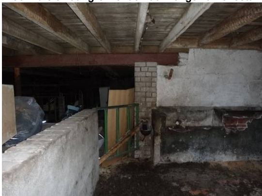
Vervallen varkensstal tegen woonhuis aan.
