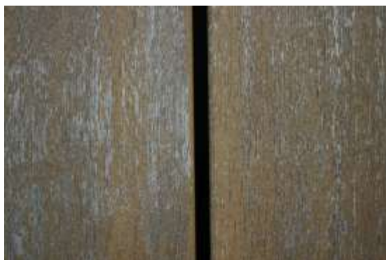
Figuur 4.4.2. De planken op deze gevel zijn op een doek gemonteerd, zodat kleine zoogdieren en vogels niet naar binnen kunnen.
