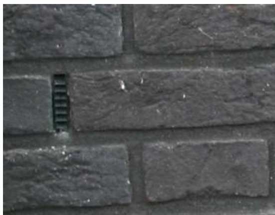
Figuur 4.4.1. De open stootvoegen zijn voorzien van roosters.
