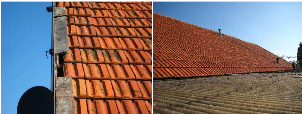
Figuur 5.1. Gaten en dakpannen die toegang verlenen tot de bedrijfswoning.
