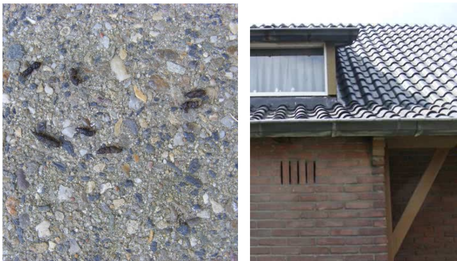
Figuur 4. Links: aangetroffen vleermuiskeutels; rechts: waarschijnlijk verblijf tussen de houten balk en de muur.
