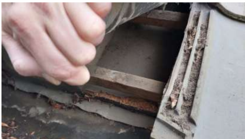
Figuur 4.4.14. Onder de onderste rij dakpannen is geen vogelschroot aanwezig, waardoor huismussen onder de dakpannen kunnen nestelen.
