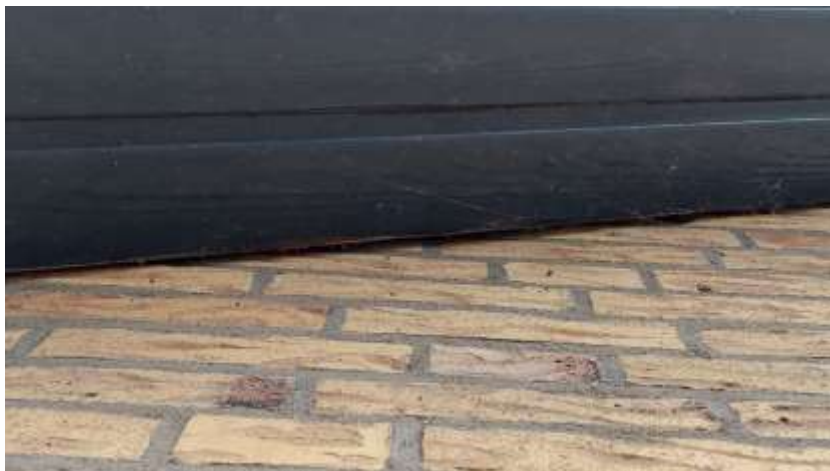
Figuur 4.4.8. Het houtwerk van het dakoverstek kiert op enkele plekken met de gevel. Vleermuizen kunnen daardoor achter houtwerk of mogelijk in de spouw verblijven.
