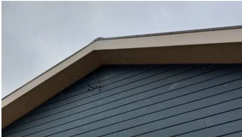
Figuur 4.4.2. Het dakoverstek bevat gladde boeiboorden en er is geen ruimte tussen het boeiboord en de metalen platen.
