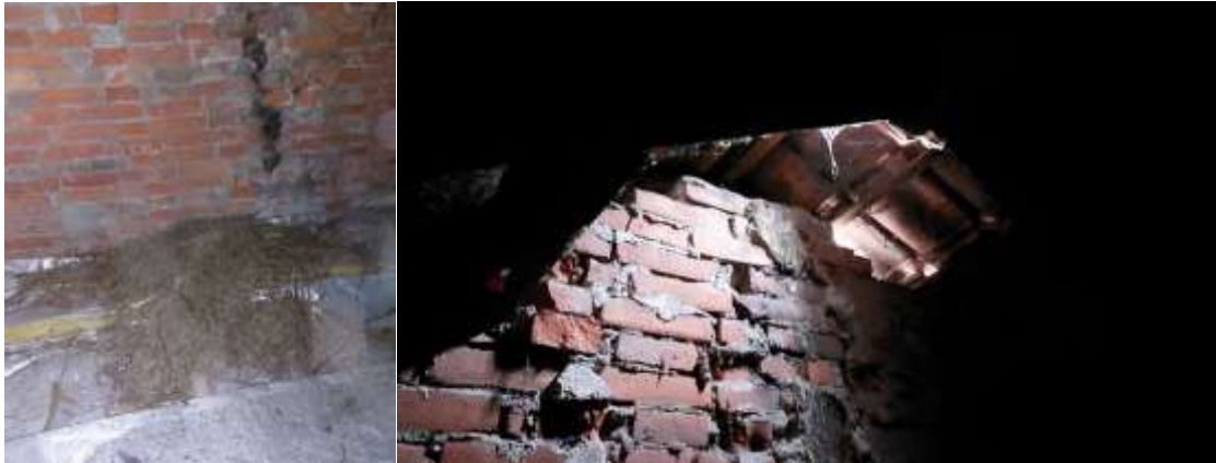
Figuur 4.4.9. Op de vloering is op twee plekken nestmateriaal van de kauw aanwezig. Bij deze plekken mist het dakbeschot en is er toegang via het dak aanwezig. Ook vleermuizen kunnen hier naar binnen.
