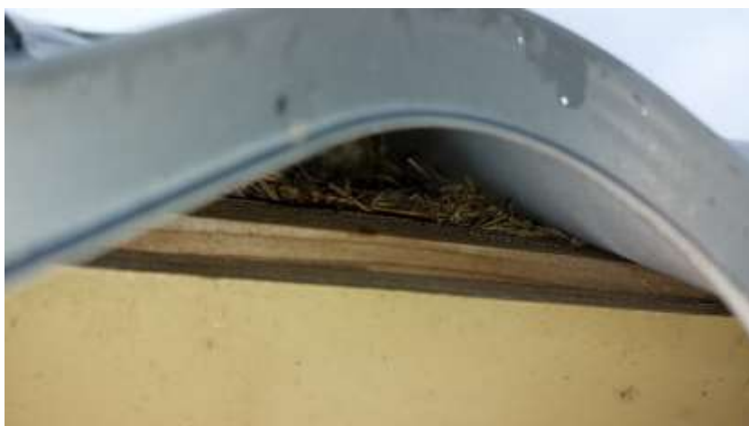
Figuur 4.4.4. Onder de metalen platen van de vrijstaande garage is geen vogelschroot aanwezig. Mussen kunnen hieronder nestelen, zoals blijkt aan de hand van de foto.
