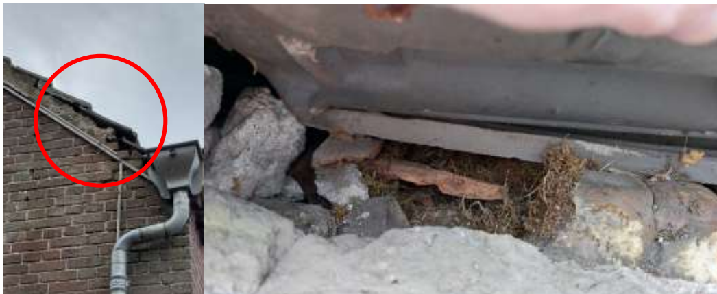
Figuur 4.4.3. De gevelpannen liggen in de specie, behalve bij de noordwesthoek. Hier bevindt zich een vervallen vogelnest. Vleermuizen kunnen hier onder de dakpannen kruipen.
