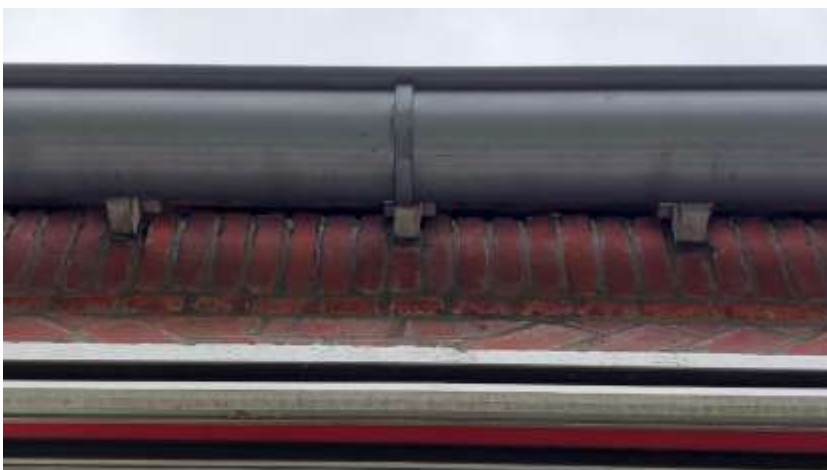
Figuur 4.4.11. De goot sluit niet nauw aan op de achtergevel. Vleermuizen en gierzwaluwen kunnen daardoor de ruimte onder de dakpannen bereiken.
