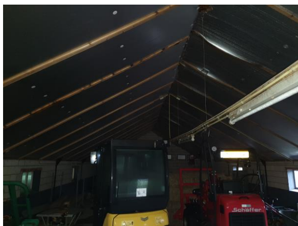
Een gedeelte van de loods is geïsoleerd met dupanel, isolatie is strak aangebracht zonder kieren en/of gaten.
