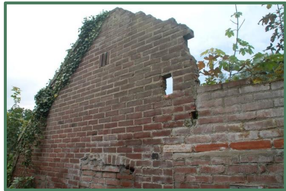
Vervallen muur voorstal
