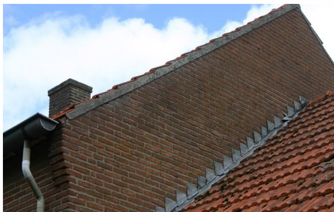
Figuur 4.4.3. De dakpannen van het inpandig woongedeelte liggen op de kopgevel in de specie en sluiten nauw aan op de zijgevel en de dakgoot, waardoor er geen ruimte aanwezig is om toegang te verlenen aan huismussen en gierzwaluwen.
