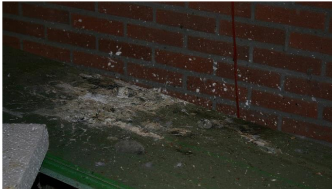
Figuur 4.4.4. In de driedeurs garage is een roestplaats aanwezig van een kerkuil, duidelijk te zien aan de hoeveelheid uitwerpselen en braakballen. Nesten waren afwezig.
