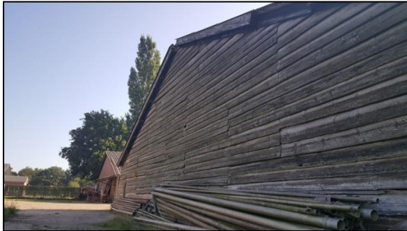
Figuur 9. Gevelbetimmering aan de noordwestzijde van één van de opstallen. Ideaal voor vleermuizen om achter te verblijven.
