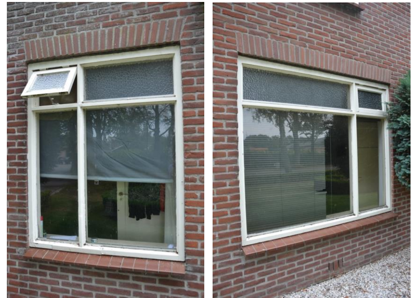
Links: meest linker venster in de voorgevel. Rechts: het tweede venster van links in de voorgevel. De strekken wijken duidelijk af van het bestaande metselwerk.
