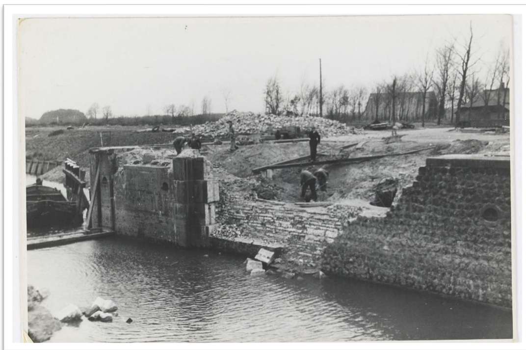
Figuur 4: 1944: Oorlogsschade aan de ophaalbrug en de sluis bij Haghorst. Bron: Beeldbank Regionaal Archief Tilburg, www.regionaalarchieftilburg.nl .
