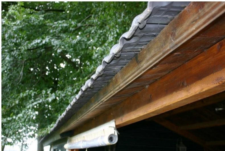
Figuur 4.5.1. Onder de onderste rijen dakpannen van het opslagschuurtje is geen ruimte aanwezig om vogels toegang tot het dak te verschaffen.
