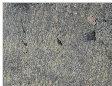
Foto 22: Uitwerpselen vleermuizen op zolderruimte.
