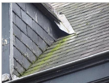
Foto 17: Openingen bij loodbeslag dak.
