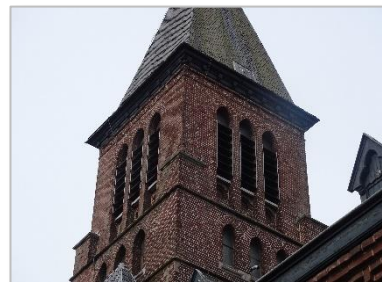
Foto 4: Galmgaten zijn in verleden afgedicht..
