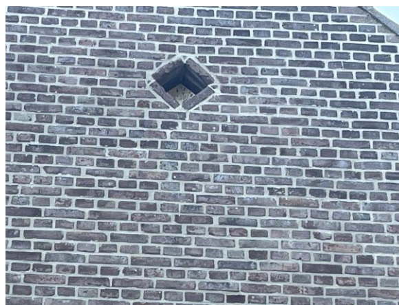
Gat in de gevel niet open.
