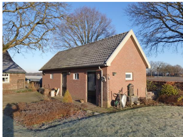
Strakke gladde windveren. Hoge gootranden. Strakke gevels geen kieren en gaten (garage wordt gesloopt).
