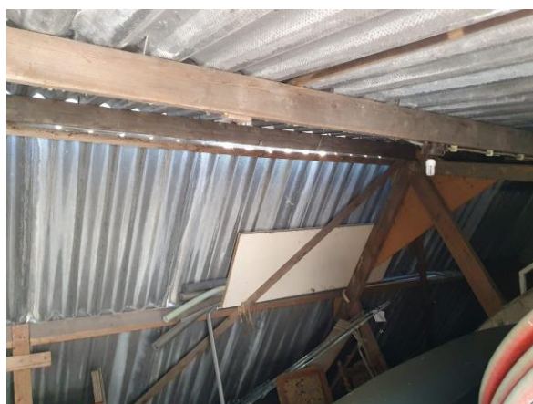
Een groot gedeelte van de gebouwen is niet geïsoleerd.
