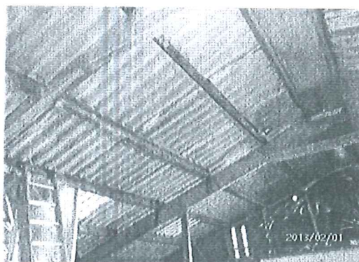
HET PLAFOND BESTAAT UI ASBESTHOUDENDE GOLFPLATEN
