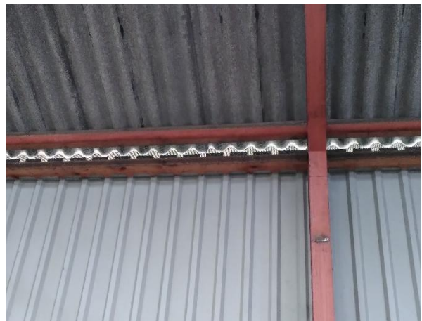
Vogelwering is op diverse plaatsen aangetroffen
