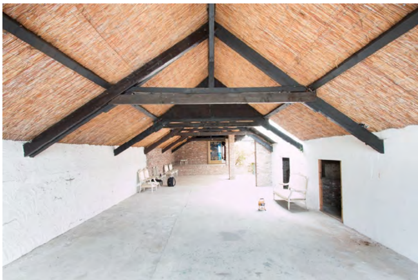
Deel van de kaspanten in de huidige toestand. De constructie is verzwakt door het wegzagen van de voetbalken. Schade die hierdoor is ontstaan, is deels 'hersteld' door balken tegen de bestaande constructie aan te zetten.
