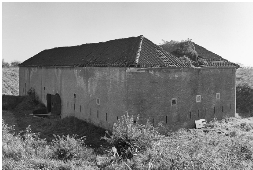
De rechter zijgevel van het gebouw in 1972. Bomen komen door het dak.
