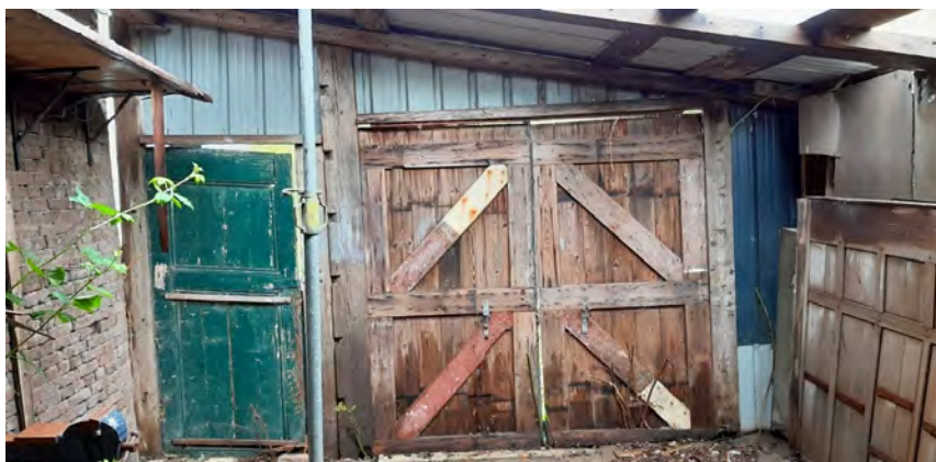
De aanbouw is van inferieure kwaliteit. Bij de bouw zijn een moerbalk en één of meerdere oude deuren hergebruikt. Rechts op de foto een houten lambrisering van elders.
