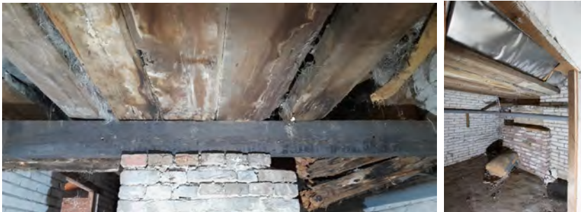
Een deel van de zakgoot is nog intact. Hierop zijn nog restanten te vinden van de grotendeels weggezaagde voetbalken van de spanten. Tegen dit balkrestant is in de jaren zeventig een nieuwe balk gelegd. Poeren zijn in die tijd ommetseld en ondermetseld om ze draagkrachtig te maken op de betonvloer.
