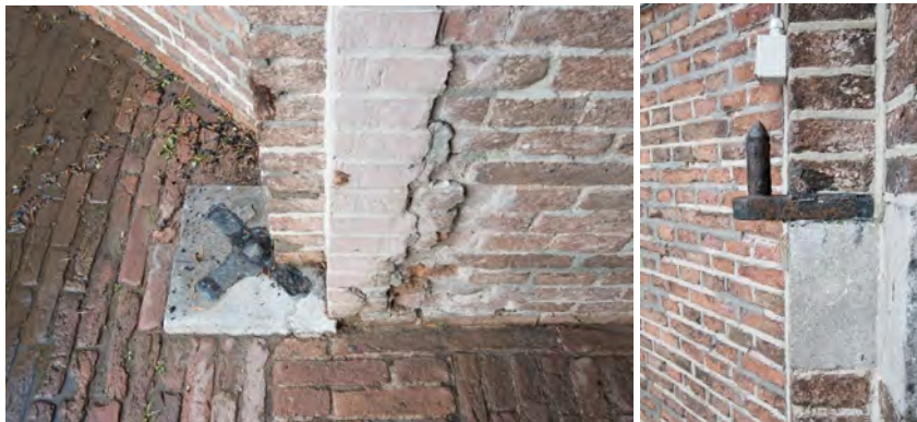
Links een taatsblok ten behoeve van een verdwenen deur. Schade aan de hoek van het metselwerk is op duidelijk herkenbare wijze hersteld. Op de foto rechts duim en duimblok ten behoeve van een verdwenen binnendeur.
