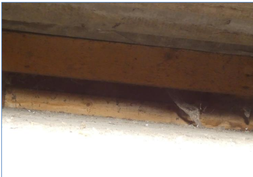
Fot 16 Nagenoeg schone ruimtes boven de isolatie
