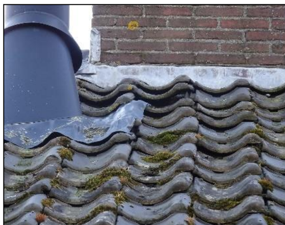
Figuur 12. Ruimte onder losliggende dakpannen en onder het daklood.
