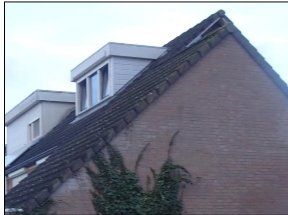
Figuur 16. Overhangende dakpannen.
