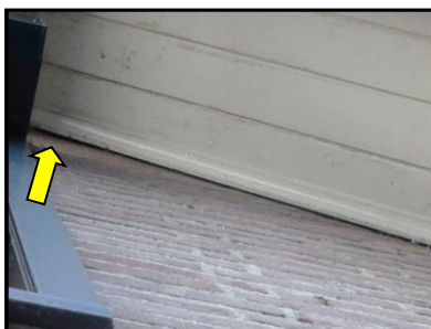
Figuur 11. Ruimte tussen de boeidelen en de muur.
