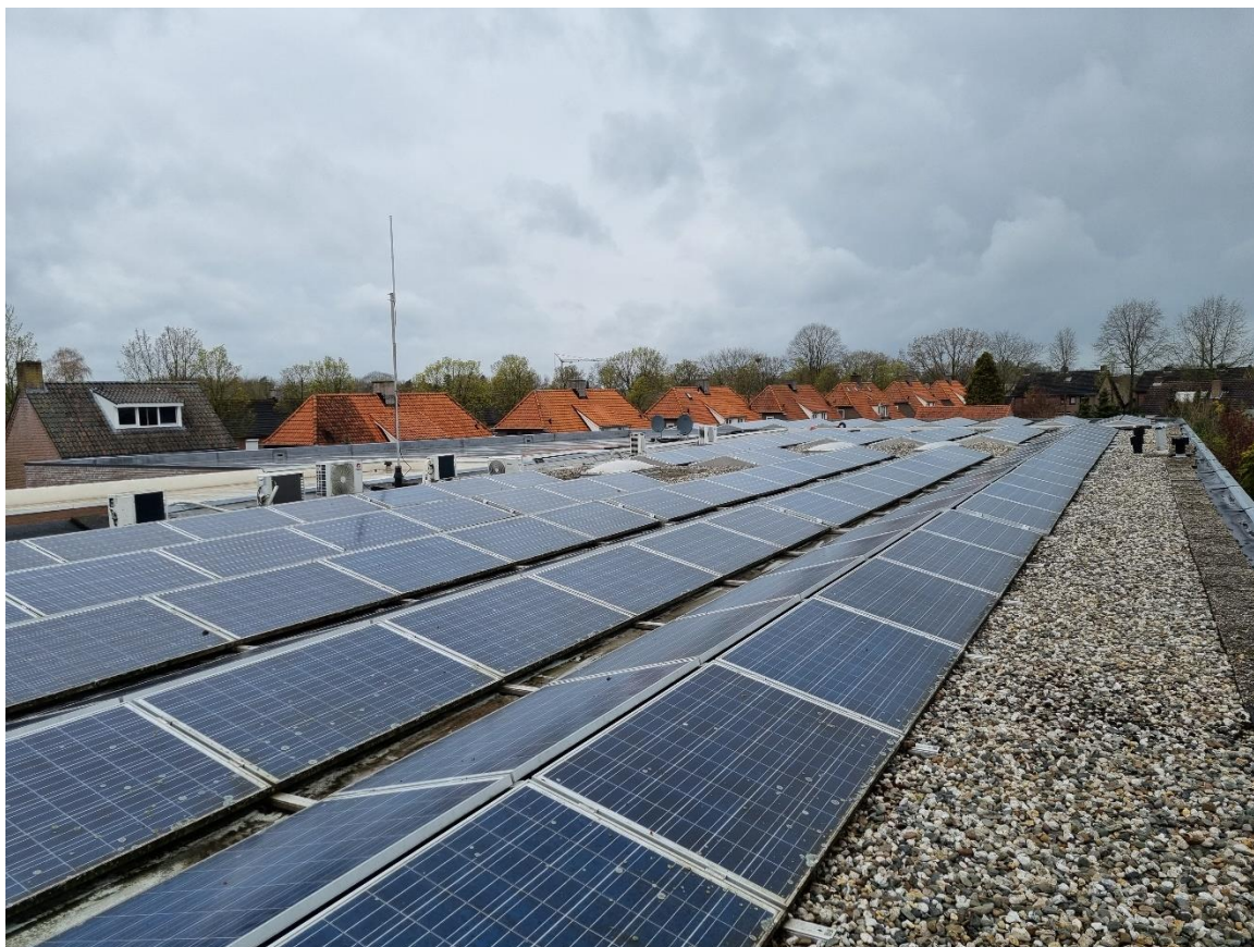
Figuur 10 Zonnepanelen op het platte dak, met een grindlaag daar omheen.
