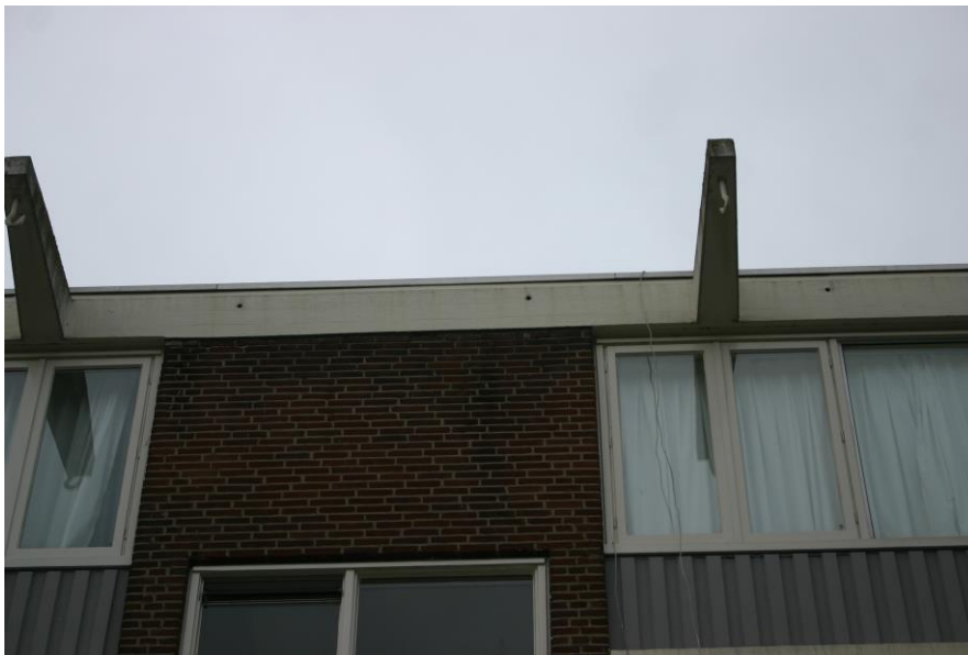
Figuur 4.2.1. De spuwgaten onder de dakrand zijn ongeschikt voor vogels en vleermuizen.
