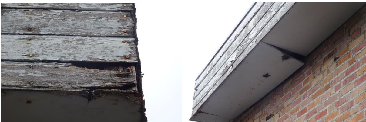
Afbeelding 5 en 6: Openingen in de gevelbekleding van het winkelpand, welke toegang kunnen bieden naar mogelijk geschikte verblijfslocaties van vleermuizen. Bron: R.J.L. Bijvelds. Datum: 25-05-2021
