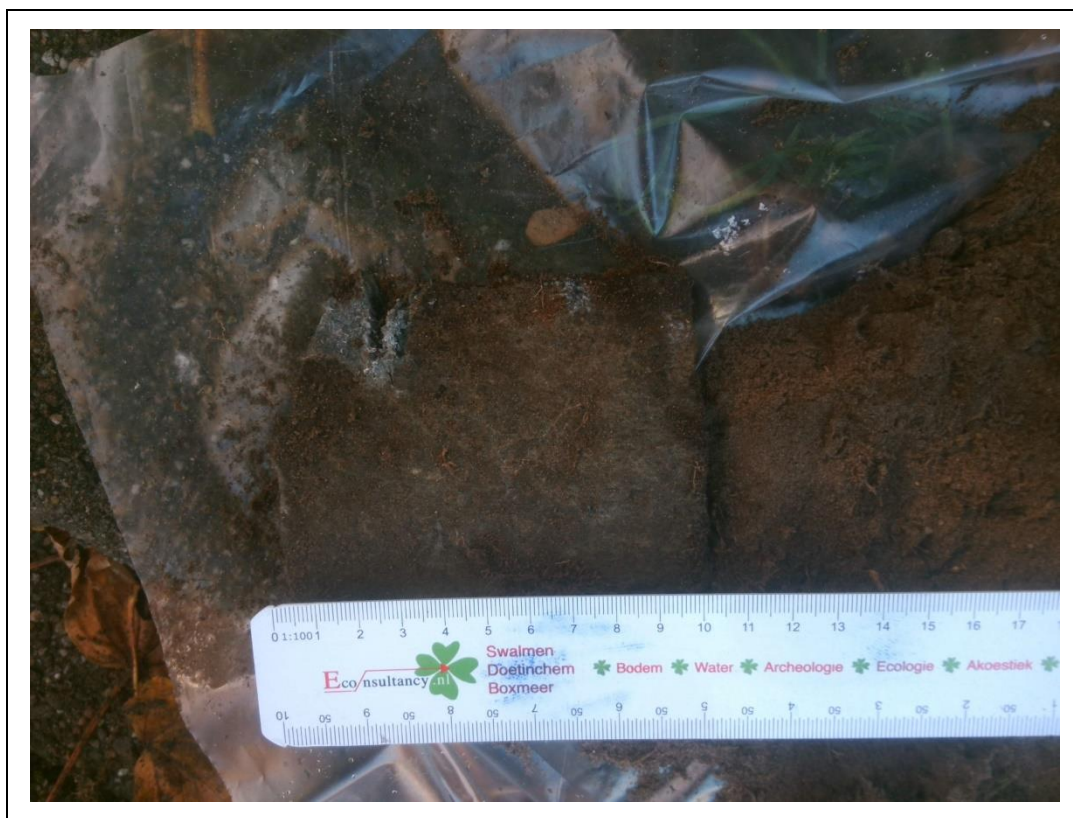
Foto 13. Asbestverdacht plaatmateriaal asbestinspectiegat E12
