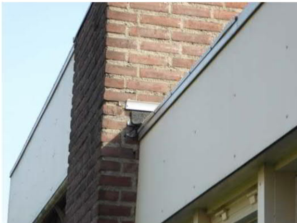
Figuur 9. Aan de onder- en bovenzijde van ramen is plaatwerk aanwezig. Waar dit aansluit op metselwerk zijn er openingen waar vleermuizen binnen kunnen komen.
