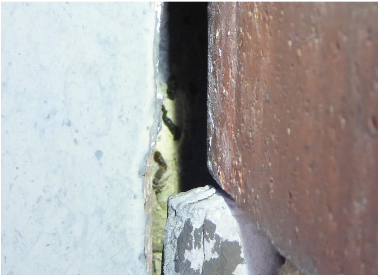
Figuur 3. Uitwerpselen van een vleermuis in een kier tussen metselwerk en dak.
